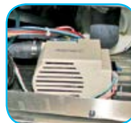
Bomba de descarga
