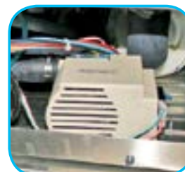
Bomba de descarga
